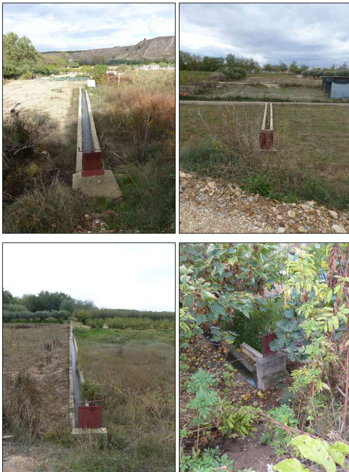
Figura 50. Fotografías de varias de las tajaderas gestionadas por el Sindicato de Riegos y que también deben ser cerradas antes de iniciarse la inundación de zonas bajas de cultivo.
