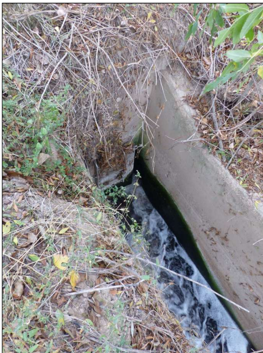
Figura 55. Imagen de la salida de las aguas de la depuradora de San Adrián, al cauce del Ebro, justo aguas arriba de la confluencia de Ega y Ebro. Esta salida está regulada mediante una clapeta, mostrada en la fotografía.
