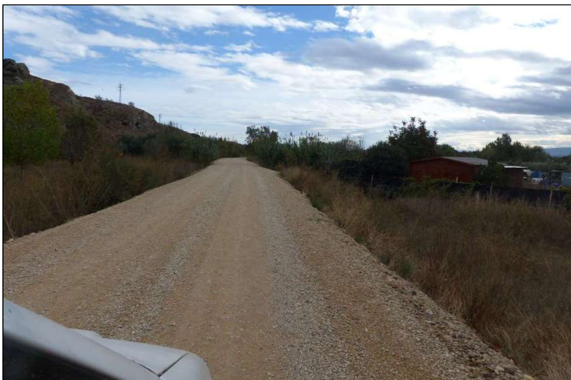
Figura 51. Camino sobre la mota – ya reparada - de la margen derecha del río Ega. La mota resultó dañada y rota completamente en varios puntos durante la inundación de diciembre de 2021.
