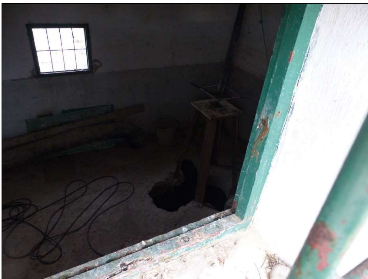
Figura 53. Fotografía de la tajadera principal que permite el cierre de las acequias de regadío en la zona aguas abajo de la depuradora. La tajadera se encuentra en el interior de una caseta cerrada con llave y que deberá ser cerrada también al activarse el plan municipal de emergencias de la localidad.
